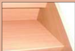
Une fine couche de silicone suffit pour faire disparaître les joints et le nouvel escalier apparaît dans toute sa beauté.
